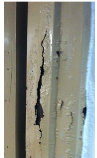
Rusted door frames DHI Photo
